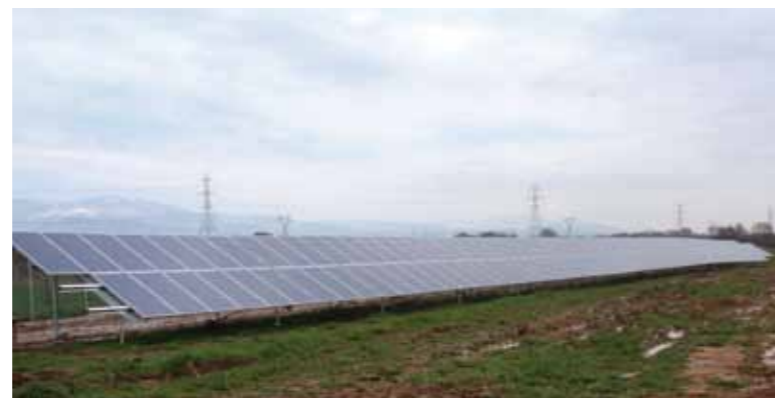
ΝΟΜΟΣ ΞΑΝΘΗΣ Φωτοβολταϊκό πάρκο ισχύος 100 KW σύστημα Σταθερών Βάσεων
