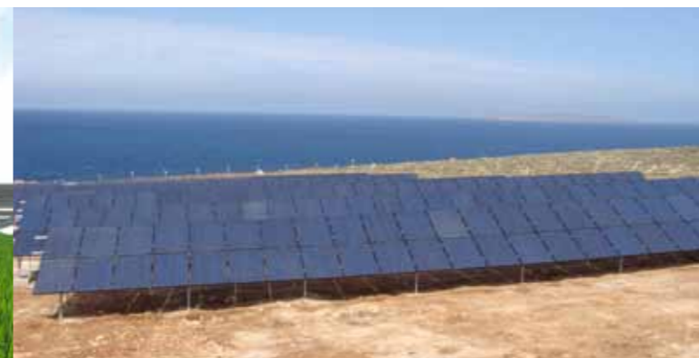
ΝΟΜΟΣ ΛΑΣΙΘΙΟΥ Φωτοβολταϊκό πάρκο ισχύος 80 KW Σταθερών Βάσεων
