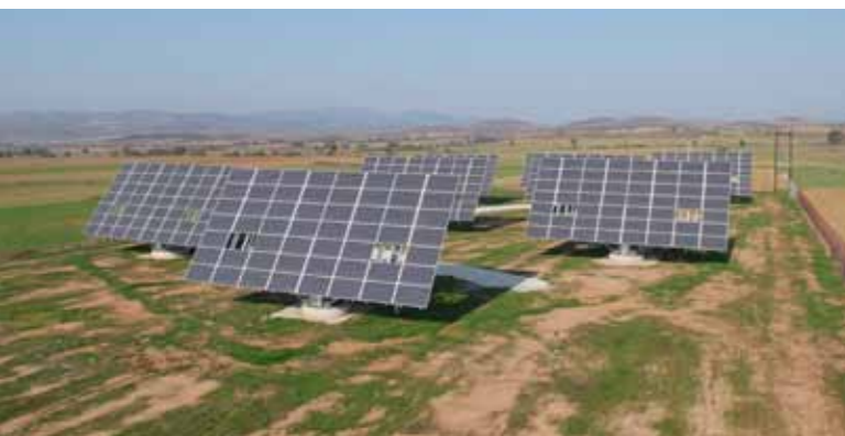
ΝΟΜΟΣ ΚΙΛΚΙΣ Φωτοβολταϊκό πάρκο ισχύος 100 KW σύστημα Tracking
