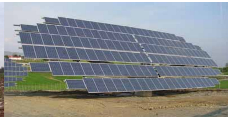
ΝΟΜΟΣ ΦΘΙΩΤΙΔΑΣ Φωτοβολταϊκό πάρκο ισχύος 100 KW σύστημα Tracking
