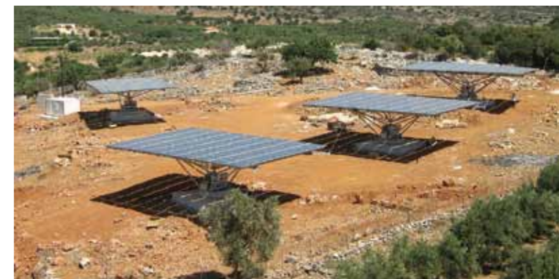
ΝΟΜΟΣ ΡΕΘΥΜΝΟΥ Φωτοβολταϊκό πάρκο ισχύος 80 KW σύστημα Tracking
