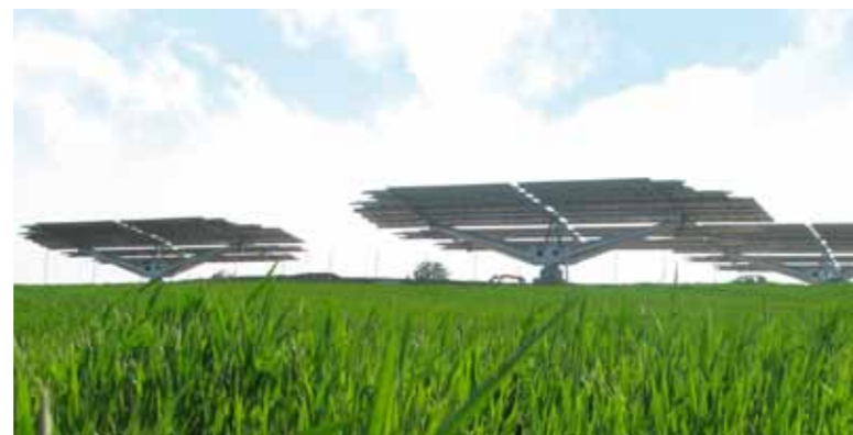
ΝΟΜΟΣ ΠΙΕΡΙΑΣ Φωτοβολταϊκό πάρκο ισχύος 100 KW σύστημα Tracking
