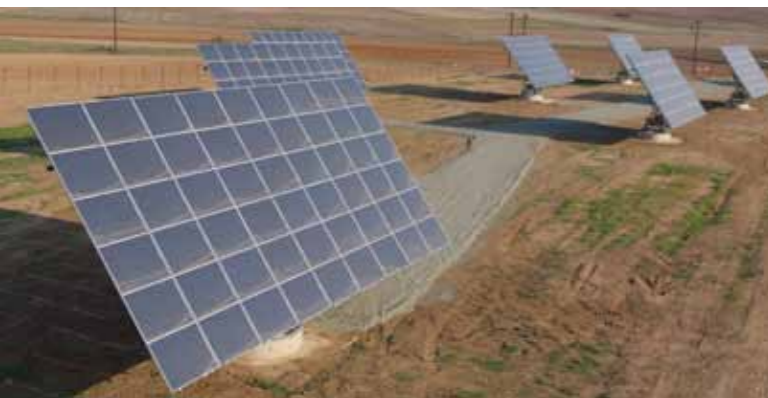
ΝΟΜΟΣ ΓΡΕΒΕΝΩΝ Φωτοβολταϊκό πάρκο ισχύος 100 KW σύστημα Tracking
