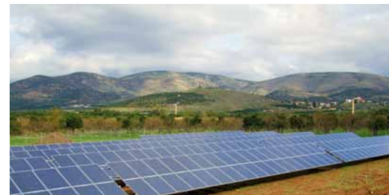
ΝΟΜΟΣ ΑΡΓΟΛΙΔΑΣ Φωτοβολταϊκό πάρκο ισχύος 100 KW σύστημα Σταθερών Βάσεων
